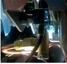
Die Position des Kontrollbrenners
