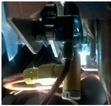
Die Position des Kontrollbrenners
